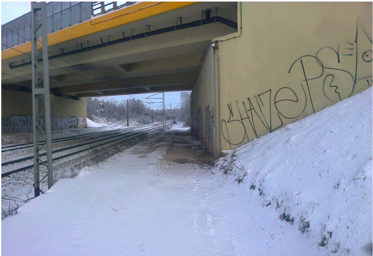
Fot. 3. Wiadukt nad linią kolejową nr 8 nie został przystosowany do spełniania funkcji ekologicznych – brak rozwiązań projektowych służących aktywności zwierząt
