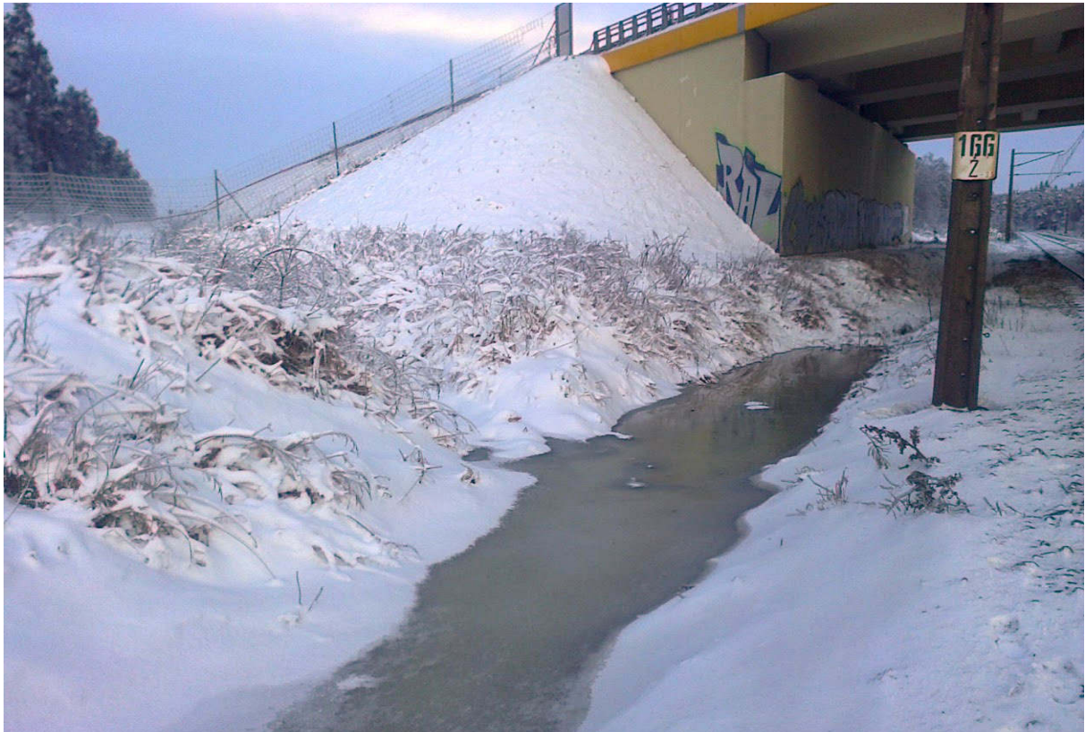
Fot. 4. Wiadukt nad linią kolejową nr 8 nie został przystosowany do spełniania funkcji ekologicznych ale stosunkowo korzystne warunki w otoczeniu powodują, że obiekt wykorzystywany jest sporadycznie przez kilka zsynantropizowanych gatunków
