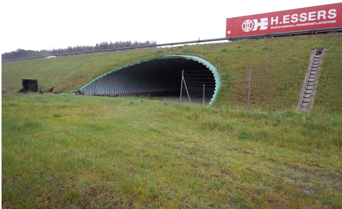
Fot. 2. Dolne przejście dla średnich zwierząt k. miejscowości Zielonka-od strony północnej obiekt posiada ogrodzenia naprowadzające – jednak zaprojektowane z błędami
