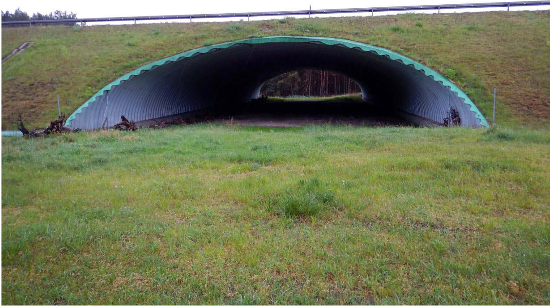
Fot. 1. Dolne przejście dla średnich zwierząt k. miejscowości Zielonka-jedyny obiekt przeznaczony do minimalizacji barierowego oddziaływania drogi
