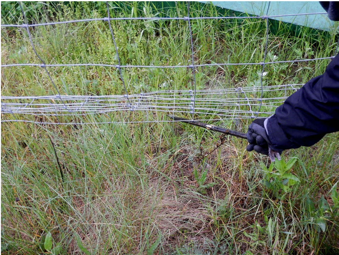
Fot. 8. Dolne przejście dla średnich zwierząt k. miejscowości Zielonka-ogrodzenia ochronne w otoczeniu obiektu posiadają liczne nieszczelności
