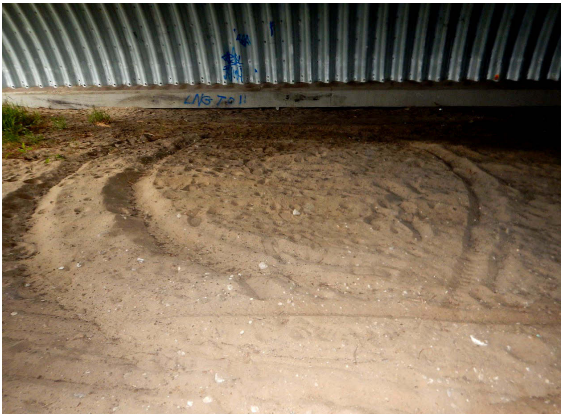
Fot. 10. Dolne przejście dla średnich zwierząt k. miejscowości Zielonka-intensywna penetracja przez ludzi i quady odstrasza leśne gatunki fauny
