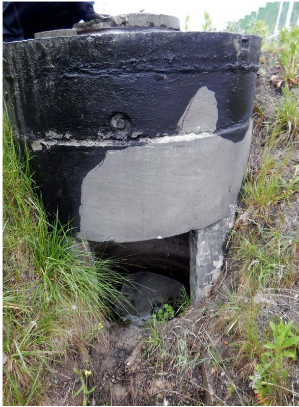
Fot. 29. Na analizowanym odcinku drogi S-5/S-10 znajdują się liczne studnie wpadowe bez zabezpieczeń-to śmiertelne pułapki dla płazów
