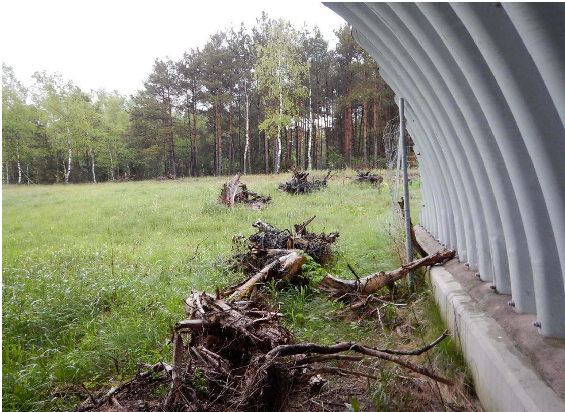
Fot. 7. Dolne przejście dla średnich zwierząt k. miejscowości Zielonka-w ramach poprawy warunków siedliskowych wyłożono karpy korzeniowe-jednak nieliczne, w wąskich pasach
