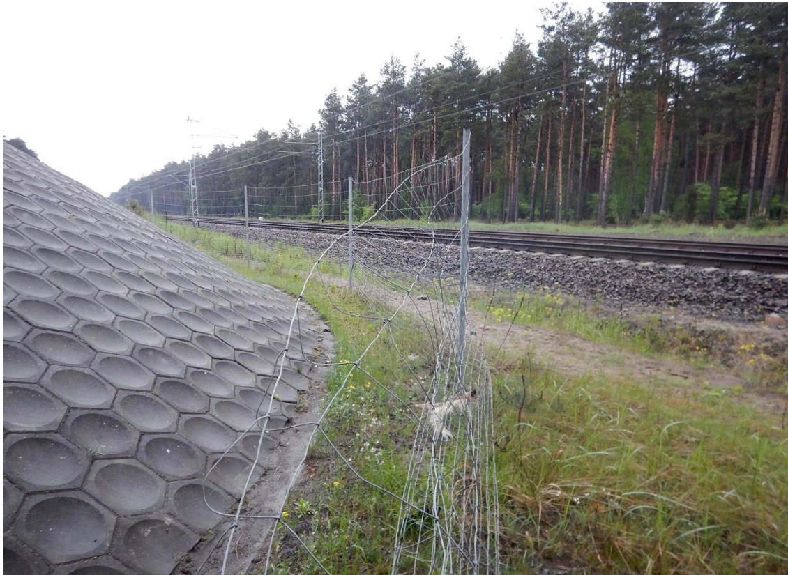
Fot. 20. Wiadukt nad linią kolejową C-E65 w miejscowości Stryzek-ogrodzenia ochronne posiadają liczne nieszczelności-zerwana siatka przy wiadukcie
