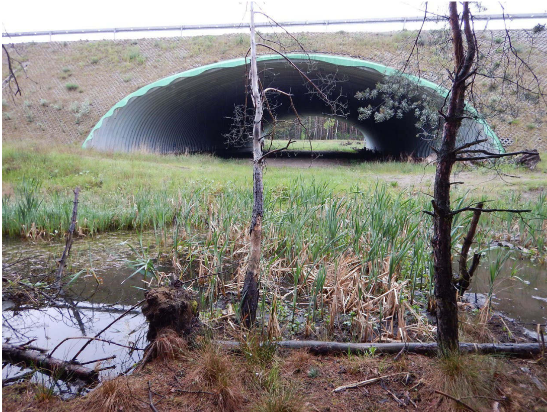
Fot. 3. Dolne przejście dla średnich zwierząt k. miejscowości Zielonka zlokalizowane jest w miejscu kolizji z cennym dla płazów, podmokłym siedliskiem
