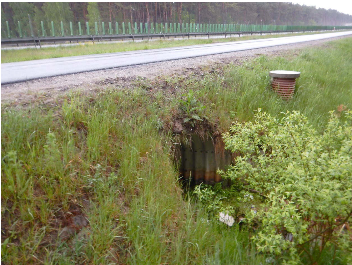
Fot. 28. Przepusty hydrologiczne przy drodze S-5/S-10 nie zostały przystosowane do spełniania funkcji faunistycznych
