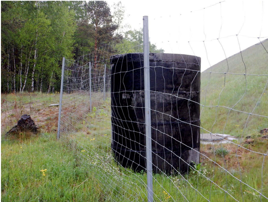
Fot. 9. Dolne przejście dla średnich zwierząt k. miejscowości Zielonka-przy wylotach obiektu znajdują się liczne pułapki dla małych zwierząt, zwłaszcza płazów
