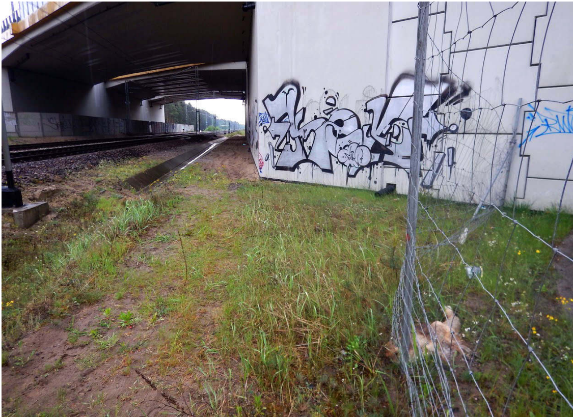
Fot. 19. Wiadukt nad linią kolejową C-E65 w miejscowości Stryzek-ogrodzenia ochronne posiadają liczne nieszczelności-martwy lis po wewnętrznej stronie płotu
