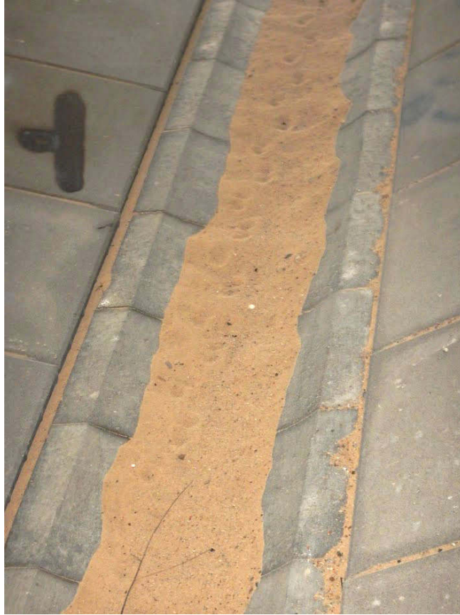
Fot. 21. Wiadukt nad linią kolejową C-E65 w miejscowości Stryzek-betonowe koryto rowu na powierzchni ogranicza powierzchnię dostępną dla zwierząt
