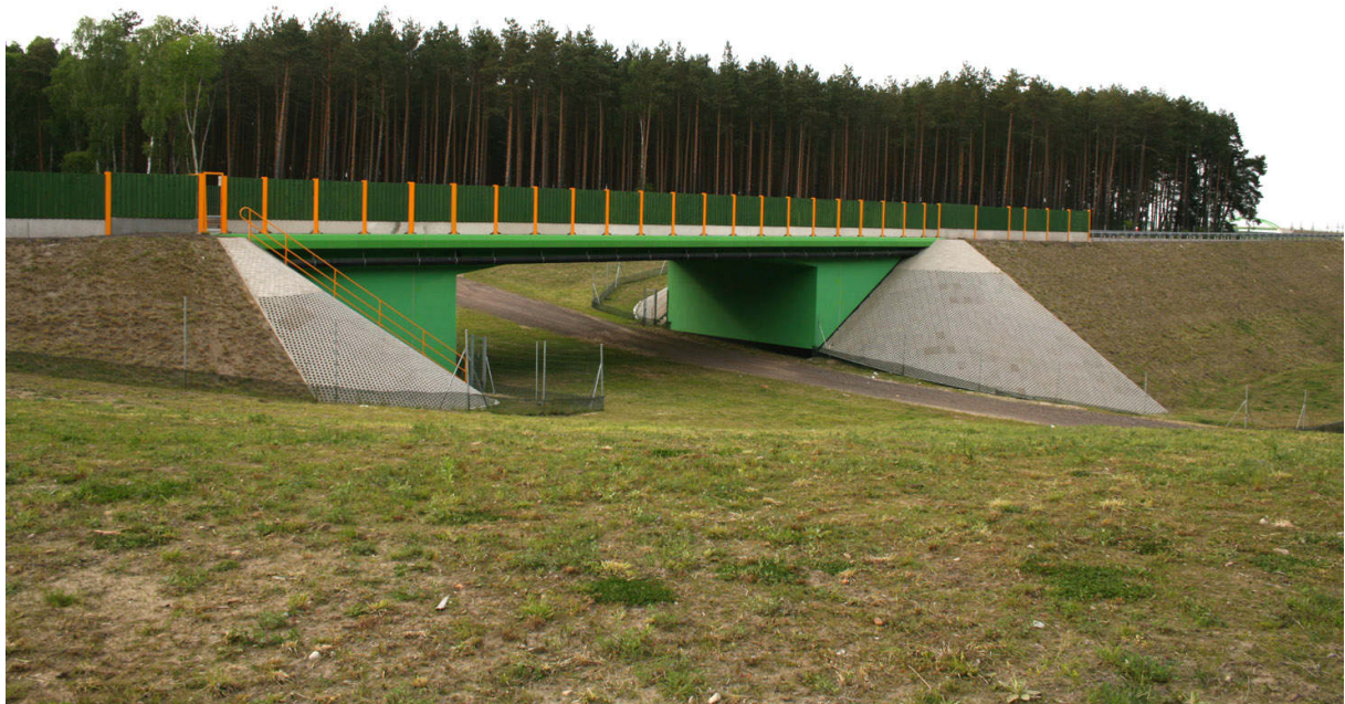
Fot. 3. Przejście dolne dla dużych zwierząt k. miejscowości Chełmsko – skrajnie ubogie zagospodarowanie powierzchni i otoczenia jest niedostosowane do siedlisk leśnych i znacząco ogranicza liczbę gatunków korzystających z przejścia.
